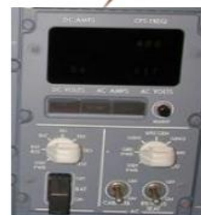
③ 电气仪表、电瓶和厨房电源组件
