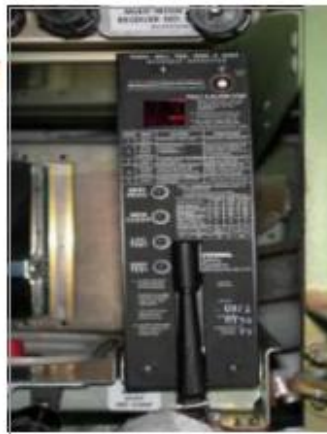
②舱体过热探测控制器
