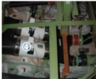
④设备冷却排气风扇
