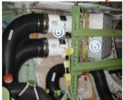
⑤设备冷却空气滤 ⑥设备冷却供气风扇
