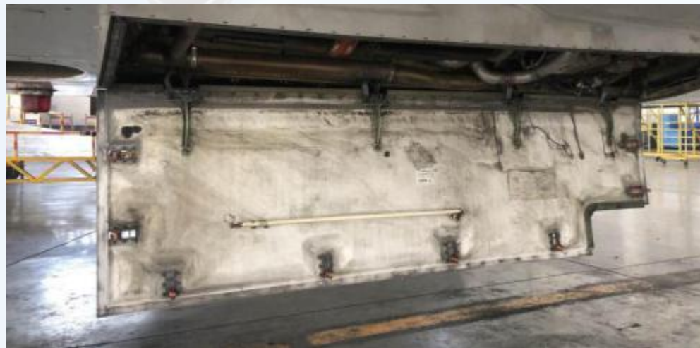
空调舱舱门打开
