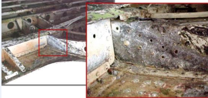
桁条、隔框及蒙皮内侧的腐蚀
